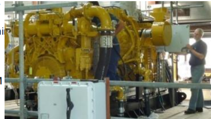
1.5 MW biogas engine/generator
